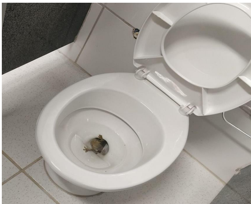
Figura 77 – Perereca subindo pelo encanamento do vaso sanitário
