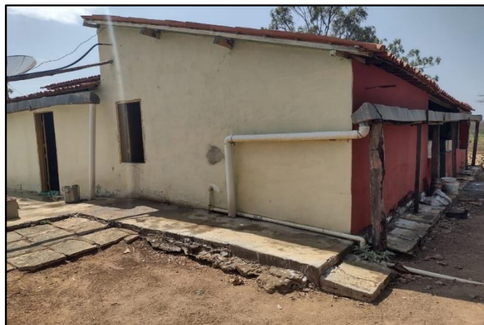
Imagem 5: Sistema de calhas para coleta de água
