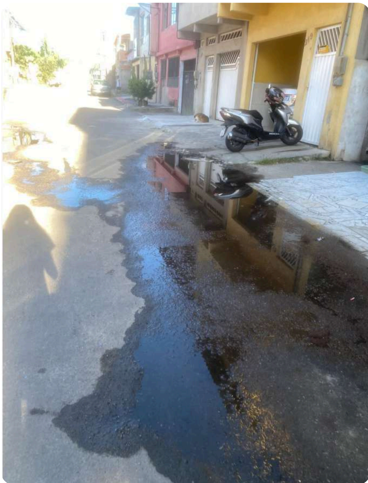
Figura 3: Esgoto a céu aberto
